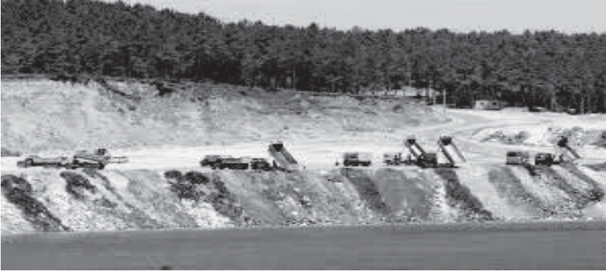
Orman alanına hafriyat dökümüne ait bir fotoğraf
